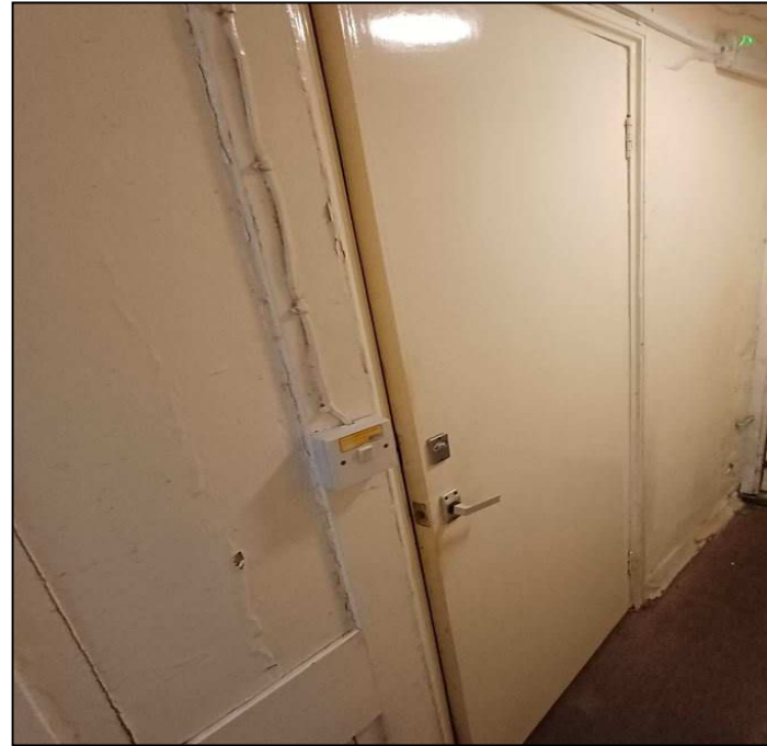
Door BD05 Basement Floor
