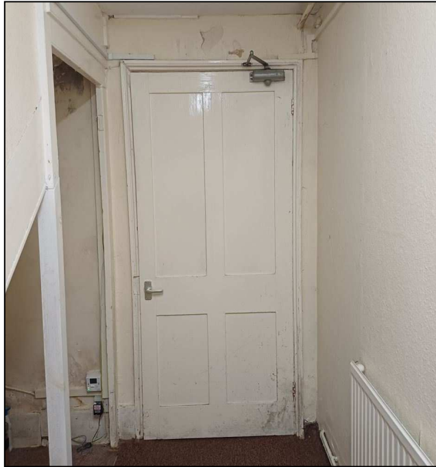
Door BD04 Basement Floor
